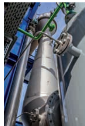
Скрубберы Вентури Körtling в работе
